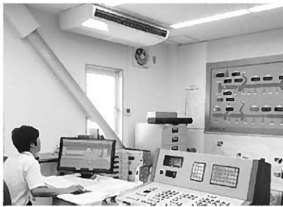
電東一貫水路集中管理室 集中制御システムの様子
