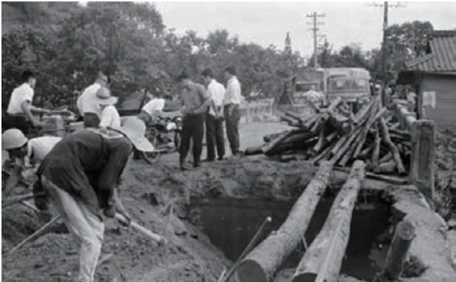
虻川橋手前の、河岸浸食による陥没 （天竜川上流河川事務所ホームページより）
