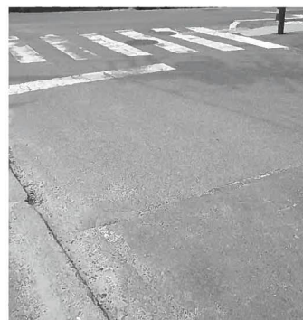
摩耗のばげしい道路の止まれ標示
