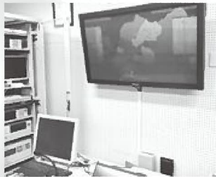
同報無線機械室
