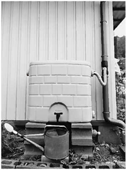
雨水貯留タンク（120 L）しとしと雨1時間でタンクがいっぱいに、年1回接続部を清掃します
