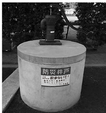
千葉県いすみ市に設置された防災井戸
