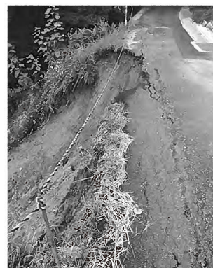
頻発する豪雨によって被災した道路
