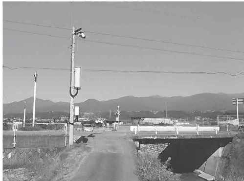
壬生沢川上流から見た河川監視カメラ（電柱の先端）
