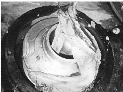
浄化センターの揚砂ポンプに絡んだタオル
