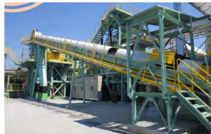
洗浄処理施設
