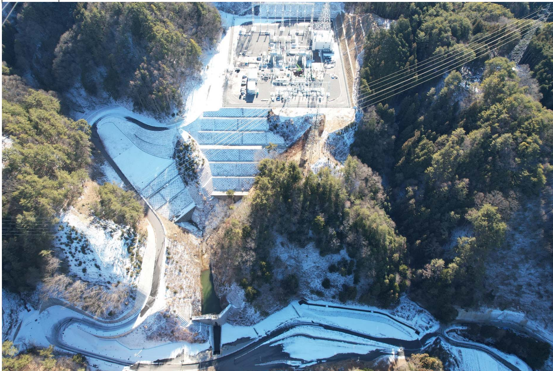
写真④ 下伊那変電所全景（上空より）
