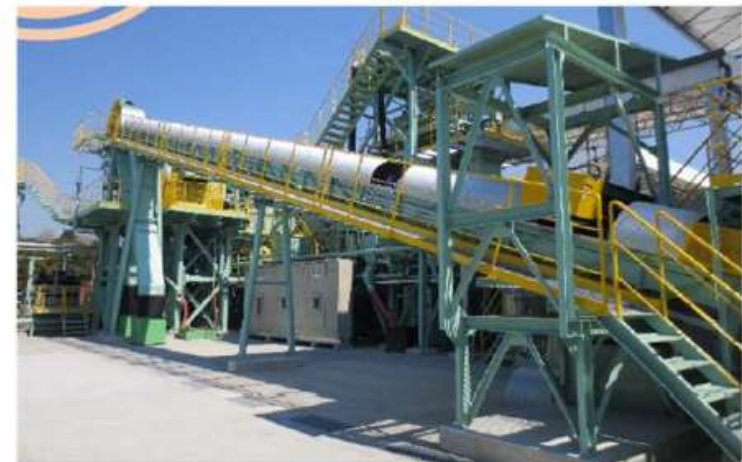
洗浄処理施設
